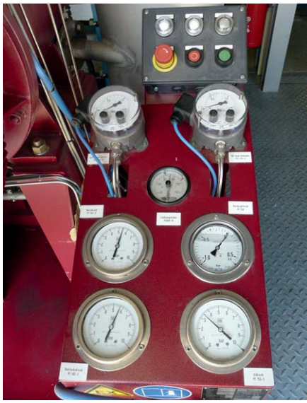
Tudo sob controle: sistemas funcionam de forma confiável e contínua e são geridos a partir de uma sala de controle central.
